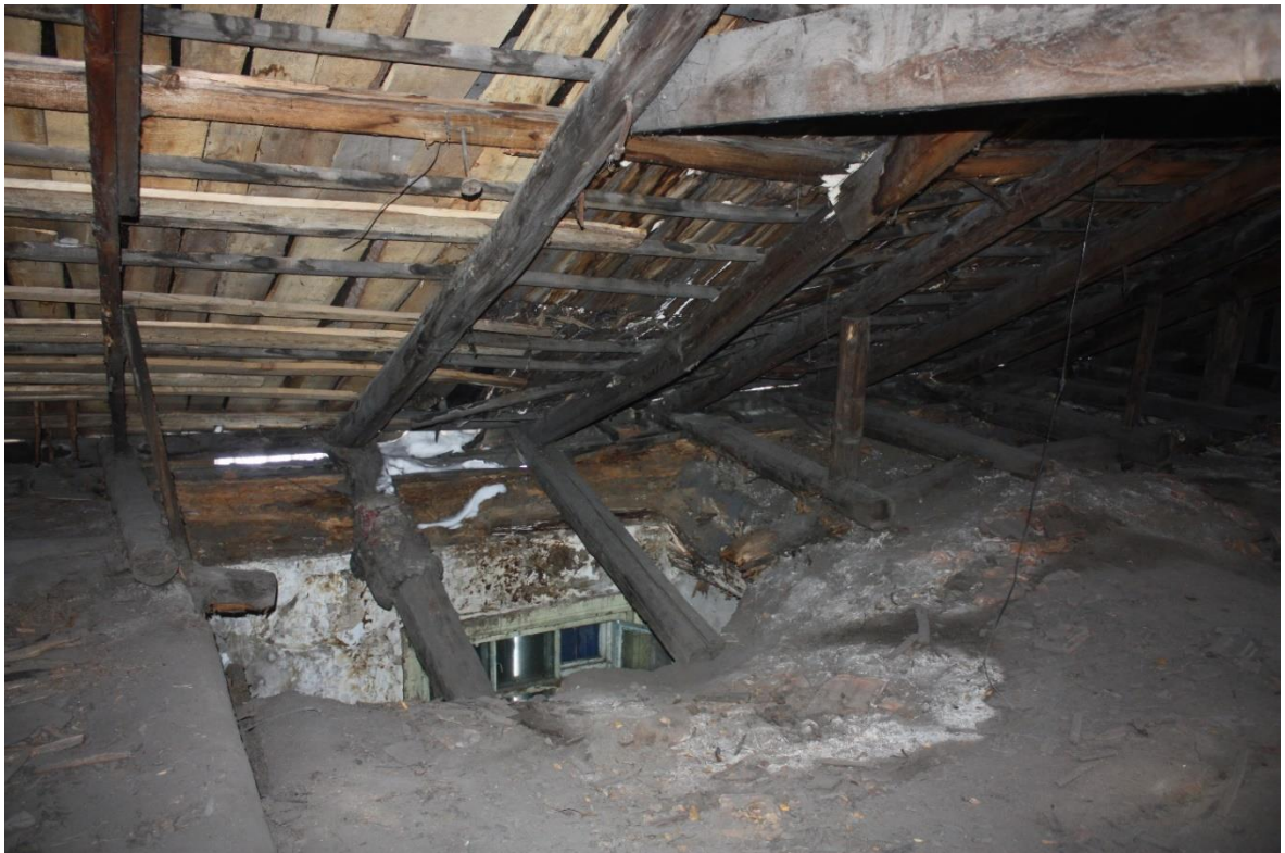
Рисунок 2.6.1 – Потеря устойчивости стропильной системы.
