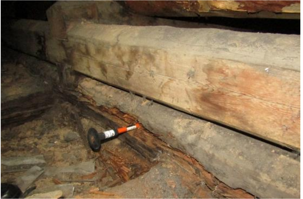
Рисунок 2.7.4 – Поражение гнилью деревянной стены
