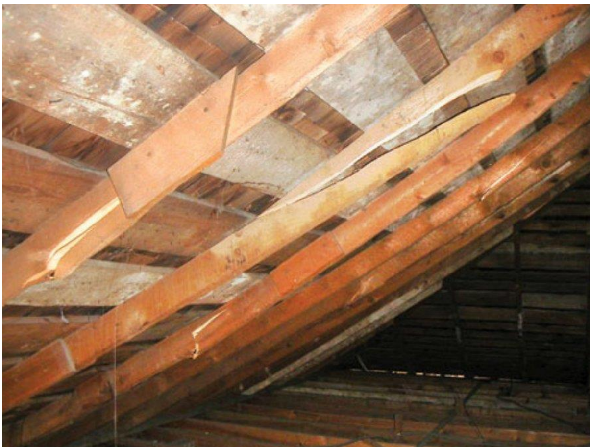
Рисунок 2.2 – Трещины в деревянных стропилах.
