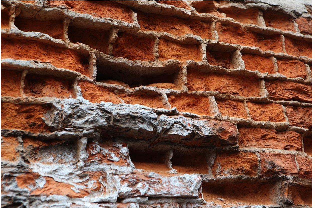
Рисунок 2.7.3 – Разрушение кирпичной кладки
