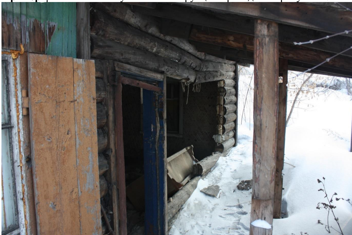
Рисунок 2.1 – Физическое отсутствие наружного простенка.
