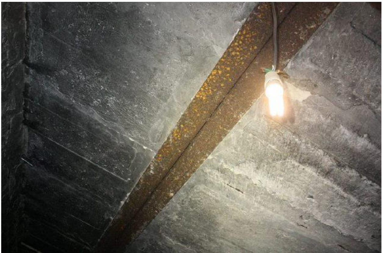
Рисунок 2.7.5 – Коррозия балки перекрытия
